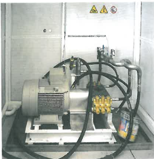
13 – La pompa che invia la soluzione detergente agli ugelli posizionati.
