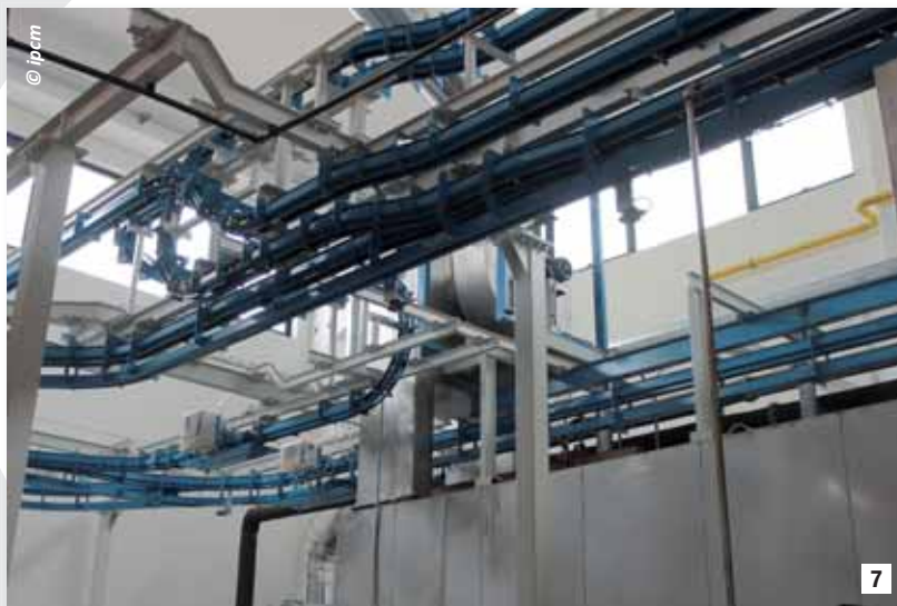
7 The double rail conveyor installed by Futura Convogliatori Aerei. Il trasportatore birotaia installato da Futura Convogliatori Aerei.
