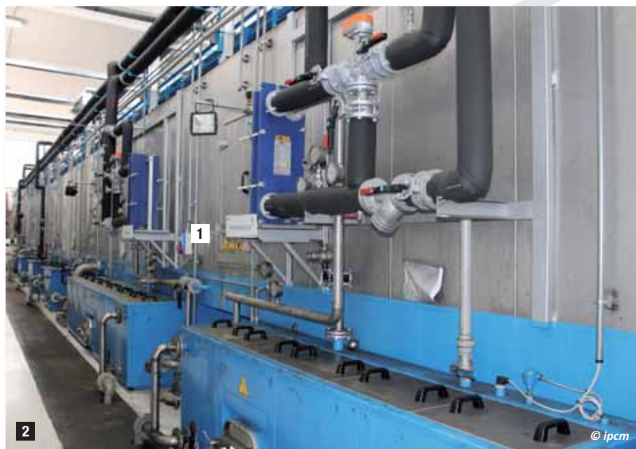
2 The pre-treatment tunnel in 9 stages. Il tunnel di pretrattamento a 9 stadi.
