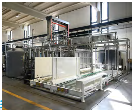
Macchina ad immersione per scatole batteria
