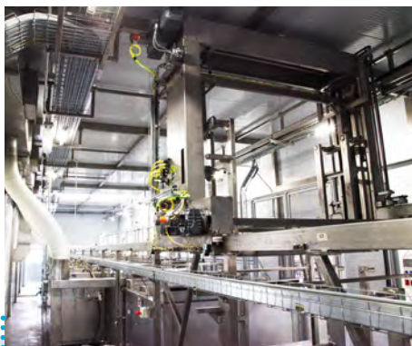
Dettaglio del carro: macchina ad immersione per componenti assali trasmissione
