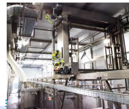
Werkstückträger der Tauchreinigungsanlage für Achs-Komponenten
