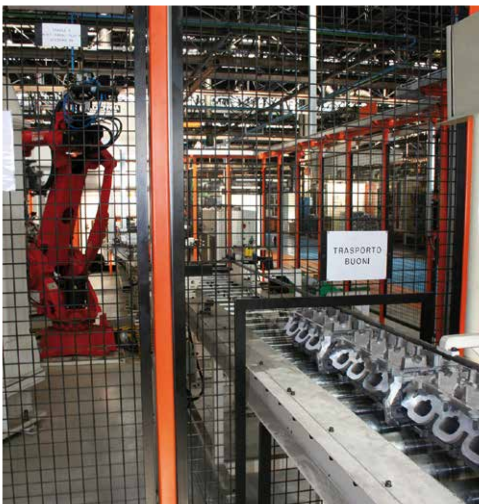
15 - I pezzi in uscita: si noti il robot, collocato direttamente nella zona protetta di uscita dall'impianto, che effettua un primo controllo di tenuta. Las piezas en salida: nótese el robot, colocado directamente en la zona protegida de salida de la instalación, que efectúa un primer control de estanqueidad.
