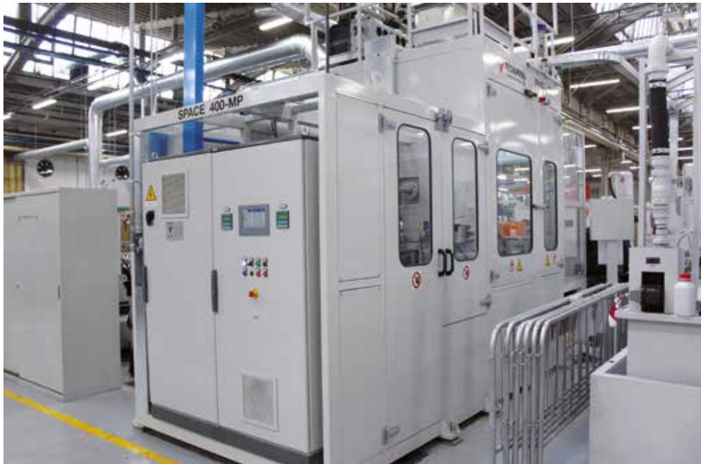
6- Una visione posteriore dell'impianto di lavaggio dal lato risciacquo e asciugatura.
